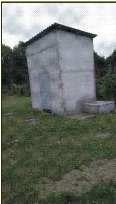
Station de pompage et forage
